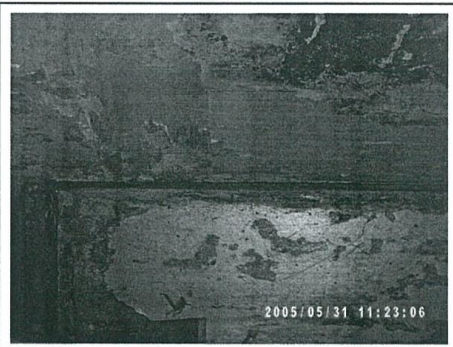
12 1층 좌,배면 벽체 균열 상태
