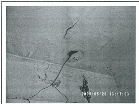
7 | 1층 계단실 상부슬래브 Con'c 박리, 철근노출, 부식 상태
