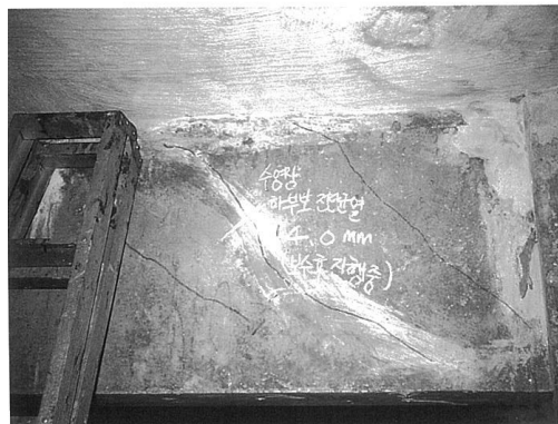
[사진 2.1] 보의 전단 균열
