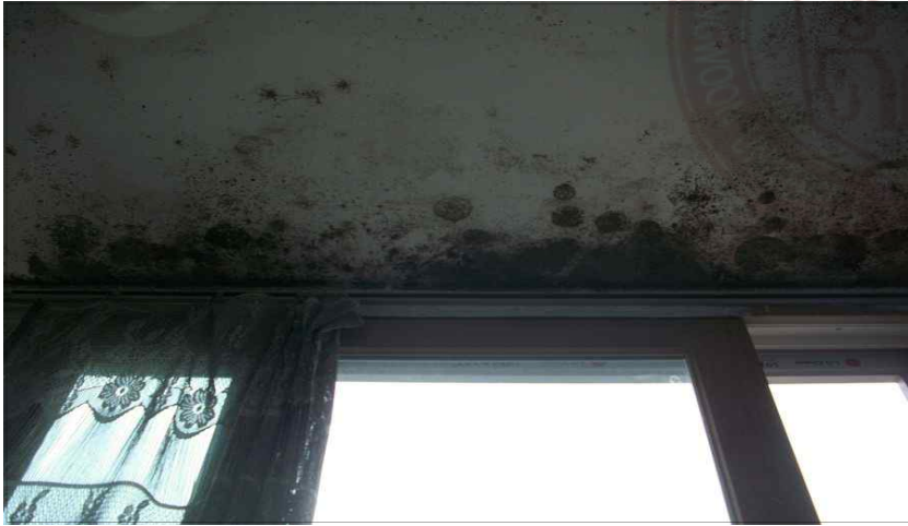
<사진 3-24> 1822호 거실 발코니 천장 곰팡이 발생
