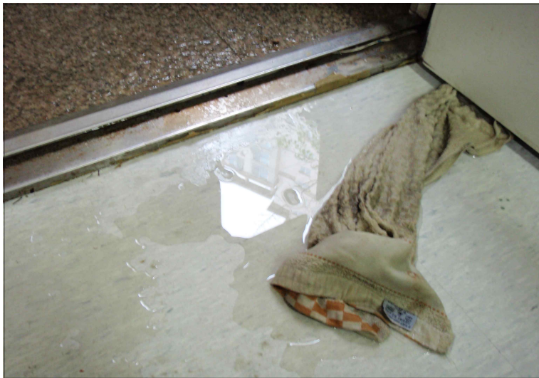
<사진 3-32> 지하주차장 엘리베이터 전실 결로수
