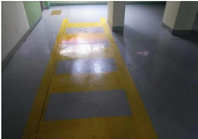
<사진 3-34> 지하주차장 바닥 세대진입로 결로 발생
