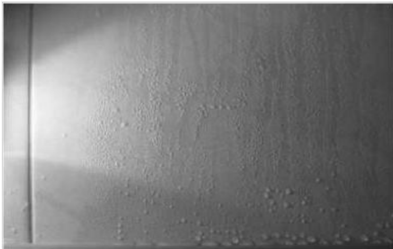
<사진 3-12> 욕실 벽면 타일 표면 결로수 맺힘
