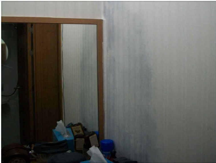
<사진 3-6> 측벽에 위치한 화장대 벽 곰팡이 현황
