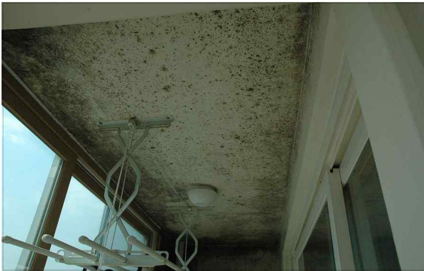
<사진 3-23> 1701호 거실 발코니 천장 곰팡이 발생
