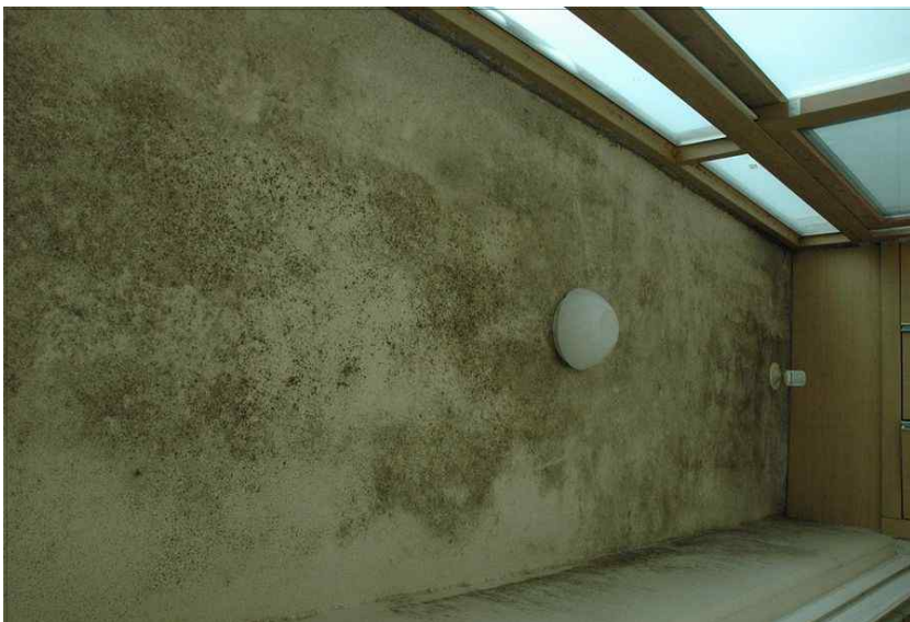
<사진 3-25> 1905호 거실 발코니 천장 곰팡이 발생
