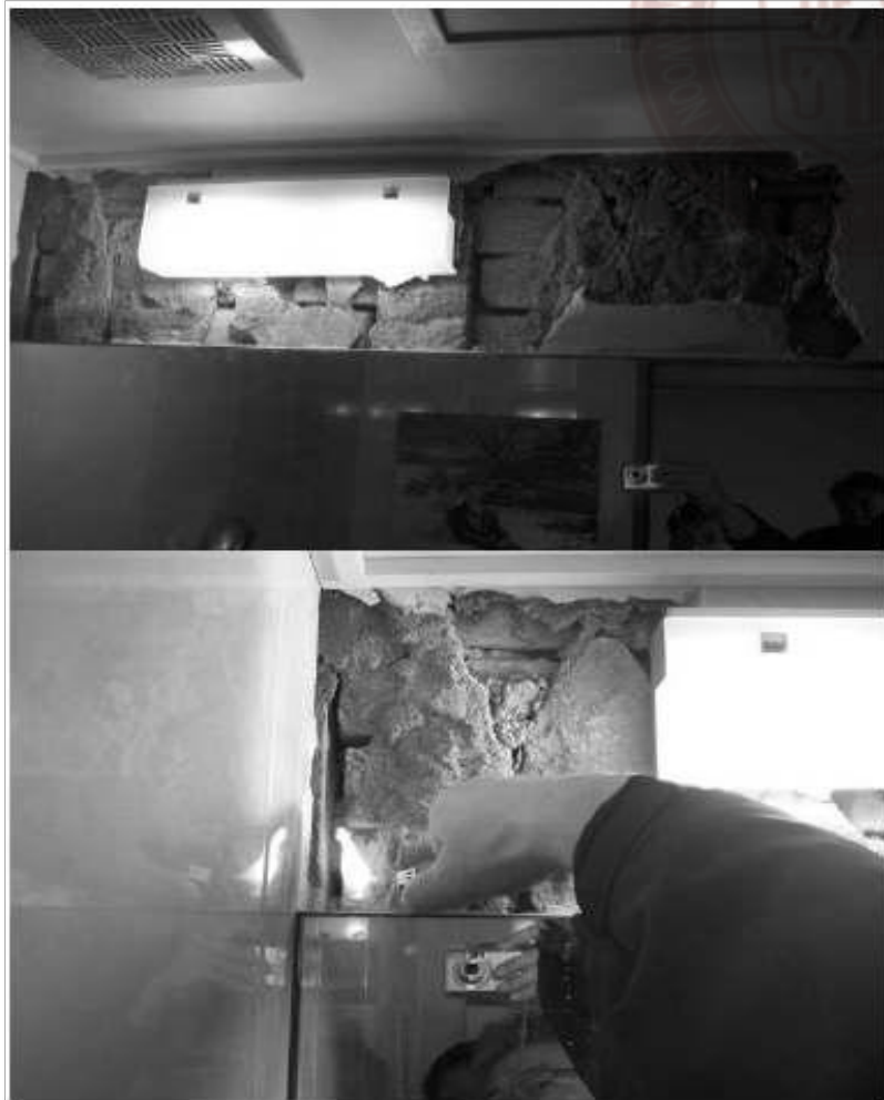
<사진 3-15> 조적벽 줄눈작업 불량, 외기 유입
