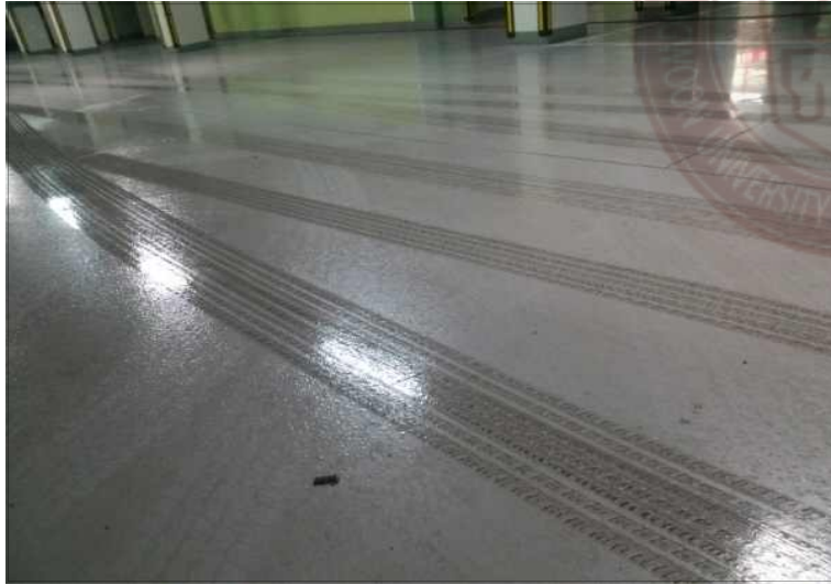
<사진 3-33> 지하주차장 바닥 결로 발생
