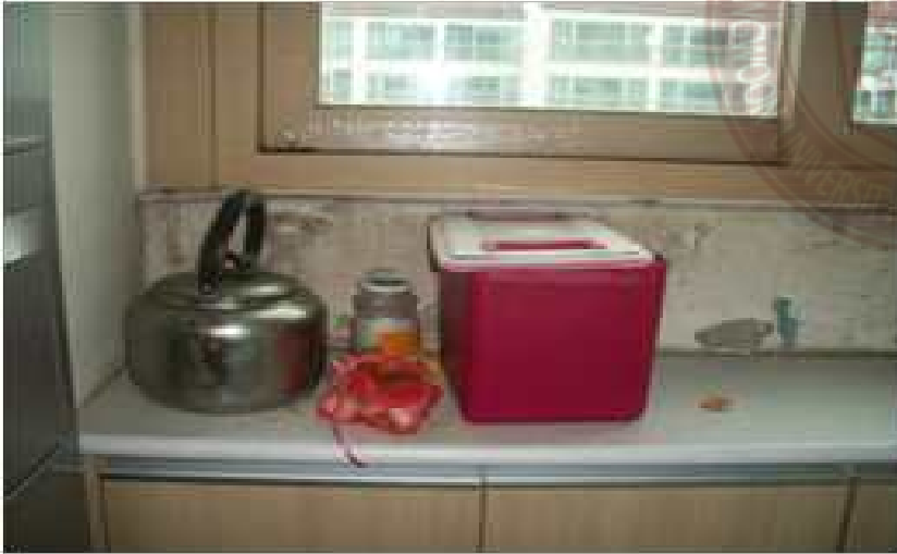
<사진 3-26> 발코니 벽체 곰팡이 발생
