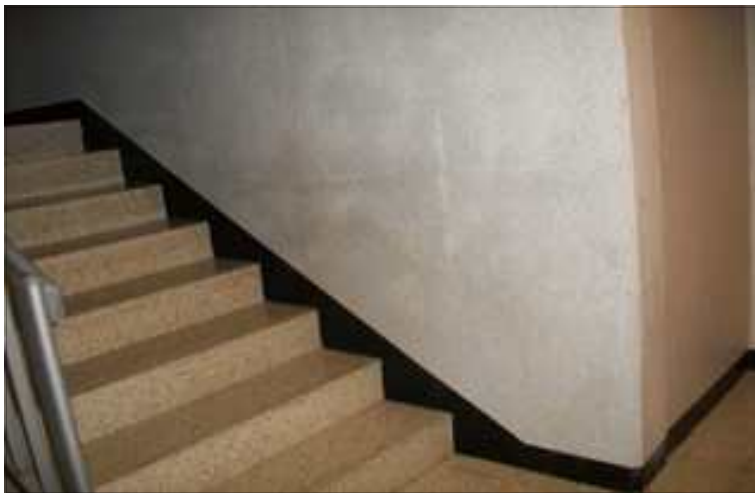
<사진 3-30> 지하주차장 엘리베이터 전실, 비상계단 바닥, 벽 결로발생
