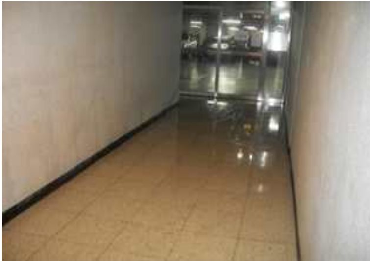
<사진 3-29> 지하주차장 세대진입로 바닥, 벽 결로발생
