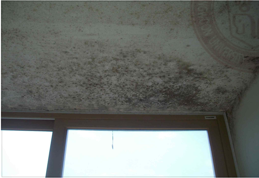
<사진 3-22> 1609호 거실 발코니 천장 곰팡이 발생
