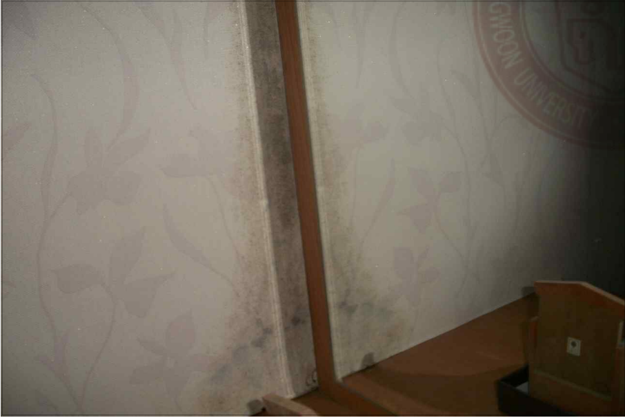
<사진 3-3> 측벽에 위치한 화장대 벽 곰팡이 현황
