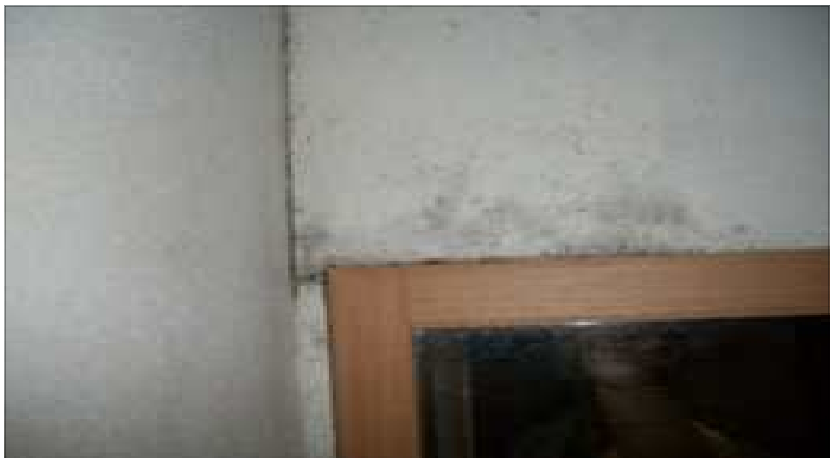
<사진 3-7> 101동 1502호 구조 접합부 파우더실 벽체 곰팡이 발생
