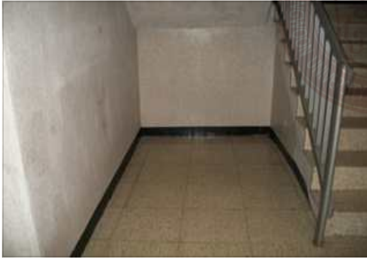
<사진 3-31> 지하주차장 비상계단 바닥, 벽 결로발생
