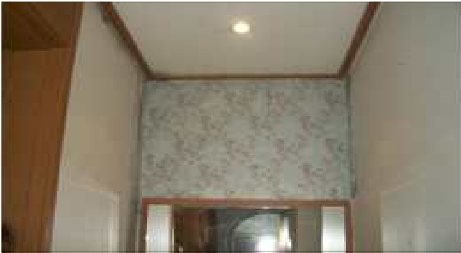
<사진 3-9> 102동 1502호 파우더실 벽체 곰팡이 발생
